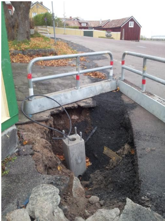
Figur 16. Fundamentsgrop A3-6 i korsningen Sjötullsgatan – Strandgatan. Här fanns endast sand och grus under asfalten. Foto från sydost, 2014-10-17.
