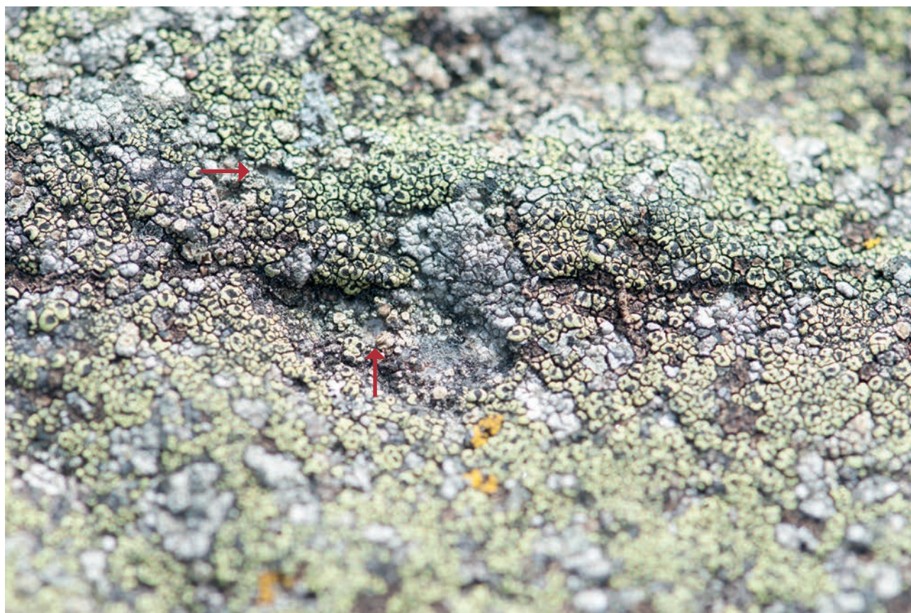
Detalj av U 898. Pilarna pekar på två färska bortfall av mineralkorn. Mellan pilarna finns en kant som såg ut att kunna vara en avspjälkningskant. Foto Eva Ernfridsson.
